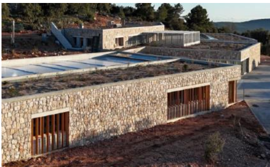
Exemple de brises soleil fixes à lames verticales - Refuge Animalier pour la SPA de MONACO
